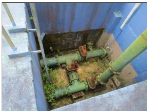
Figura 86: Equipamentos disponíveis no reservatório R7.
