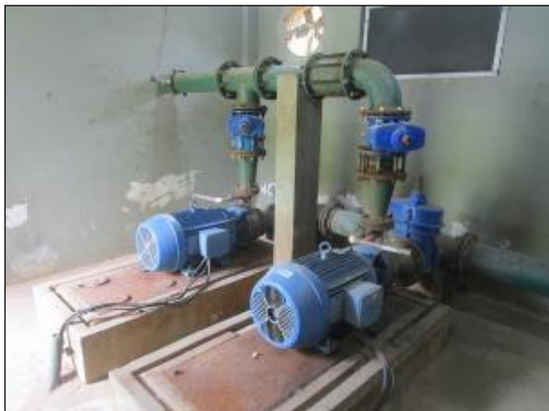
Figura 45: Bombas disponíveis para recalque da água tratada na unidade, em funcionamento e em condições satisfatórias na ERAT 07.
