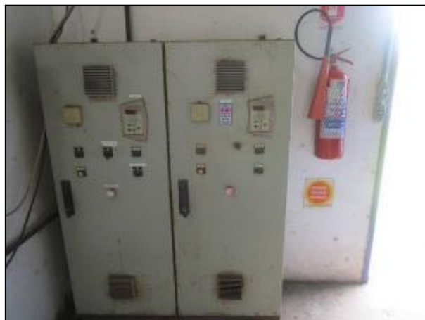
Figura 40: Painel de controle da ERAT 04 e aparelho extintor de incêndio afixado no interior da unidade.
