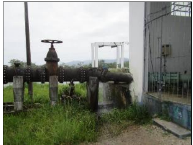
Figura 12: Vista da Adutora de Água Bruta, podendo ser verificado vazamento constante e com grande volume de água bruta sendo perdido (área central da imagem).
