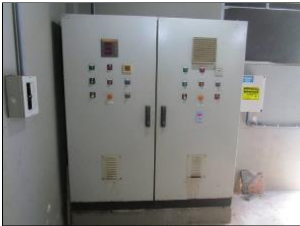
Figura 47: Vista externa do Painel de Controle da ERAT 07.
