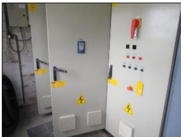
Figura 17: Vista do Painel de controle das unidades, novos, com pouco ruído e em funcionamento pleno durante a visita.
