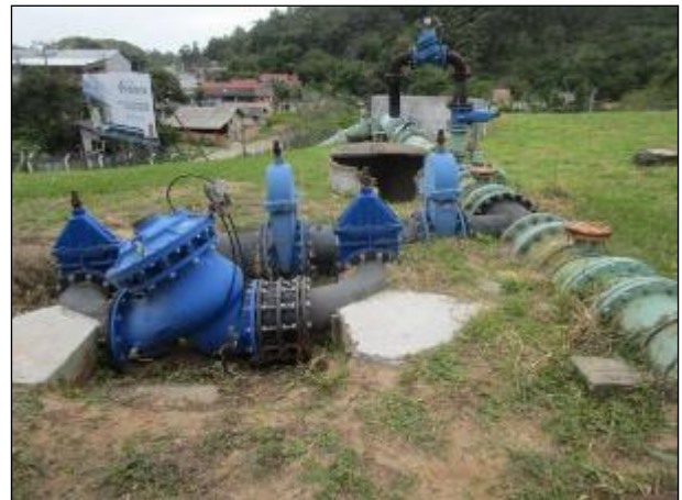
Figura 28: Vista da adutora de água tratada nas dependências da ETA Nova Brasília.
