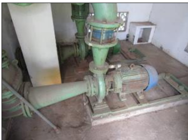
Figura 37: Conjunto de motobombas disponíveis na unidade para recalque até o reservatório R4 no bairro da Divineia.
