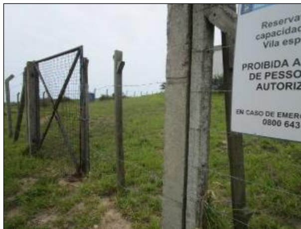
Figura 76: Vista do portão de acesso ao reservatório R6, cadeado, porém a corrente está fixada em estrutura improvisada.
