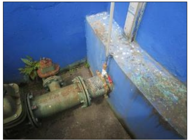
Figura 102: Equipamentos disponíveis no reservatório R7.
