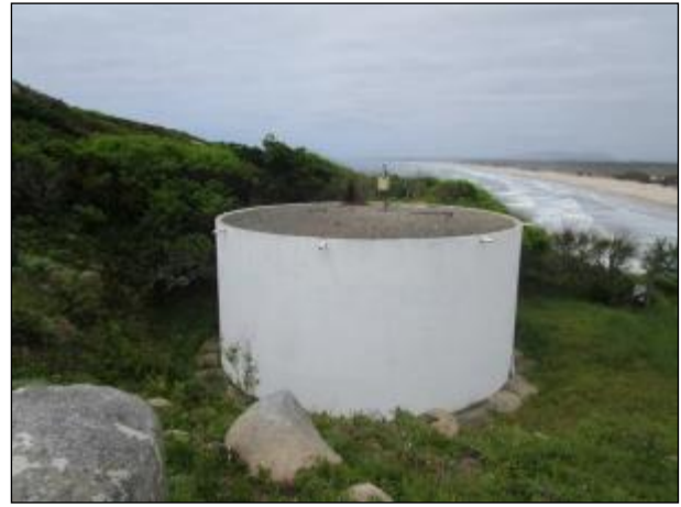
Figura 108: Vista da área superior do reservatório R10, boas condições e com o equipamento para a transmissão do monitoramento remoto visível (Praia de Itapirubá).
