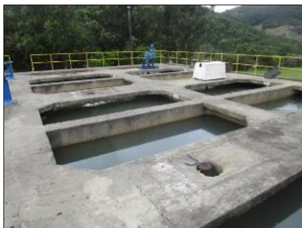
Figura 22: Parte da área de Tratamento da Água na ETA Nova Brasília.
