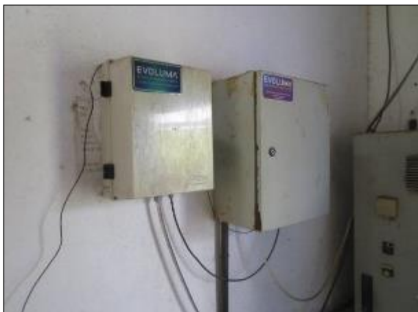
Figura 39: Equipamentos disponíveis que fazem parte do monitoramento remoto da unidade.
