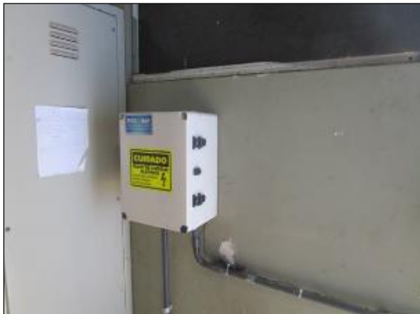
Figura 49: Parte do sistema de monitoramento remoto para supervisão da unidade.
