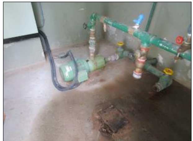
Figura 52: Bomba de recalque da água tratada na ERAT 08 disponível, porém sem a bomba reserva instalada no momento da vistoria.
