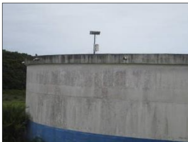
Figura 82: Detalhe do equipamento para que seja acompanhada a unidade remotamente.
