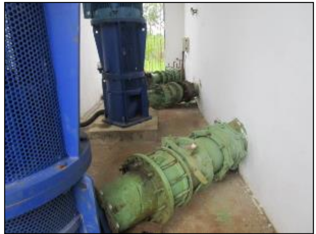
Figura 8: Vista da ERAB contendo suas 3 bombas de 300 cv, há uma reserva em manutenção, reforma do motor.
