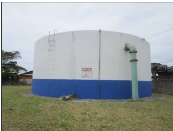
Figura 73: Vista geral da unidade, escada para acesso ao topo danificada.
