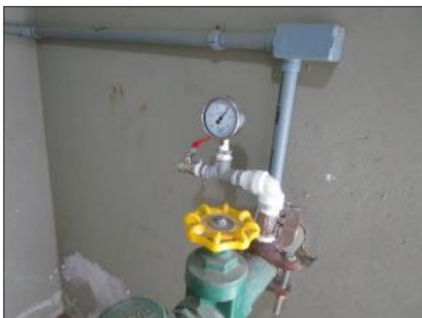
Figura 55: Equipamento instalado para que auxilie os operadores da unidade no controle.
