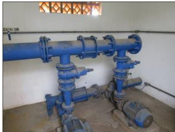
Figura 60: Vista das bombas disponíveis para o recalque da água tratada deste ponto na ERAT 09, na Vila Nova, até o reservatório R9, em São Tomás.
