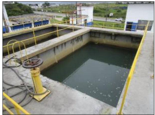
Figura 24: Parte da área de Tratamento da Água na ETA Nova Brasília.
