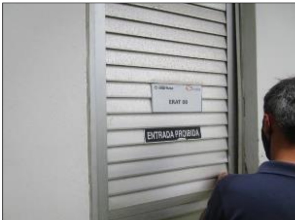
Figura 51: Vista da entrada da unidade ERAT 08, localizada junto ao reservatório R7, no bairro de Ibiraquera.
