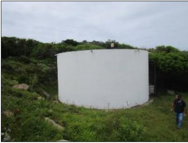
Figura 107: Vista do reservatório necessitando de pintura com as cores da concessionária. Limpeza da área onde o reservatório R10 está localizado em condições satisfatórias.
