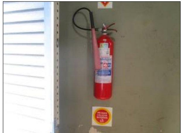
Figura 50: Vista de aparelho contendo agente extintor de incêndio BC disponível para uso imediato, localizado na ERAT 07.
