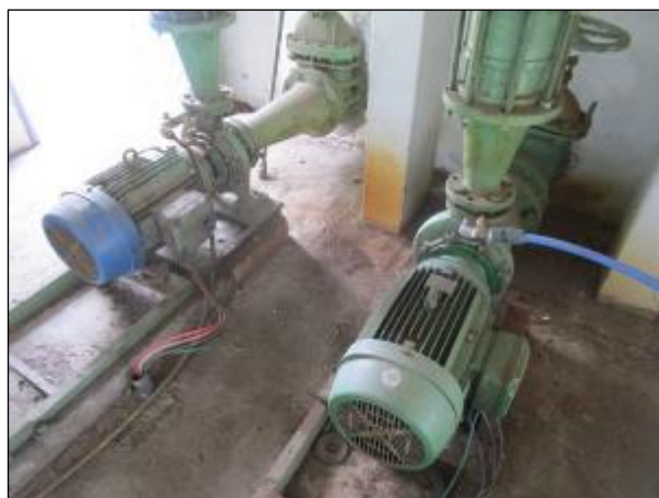
Figura 38: Conjunto de motobombas disponíveis na unidade ERAT 04, em funcionamento.
