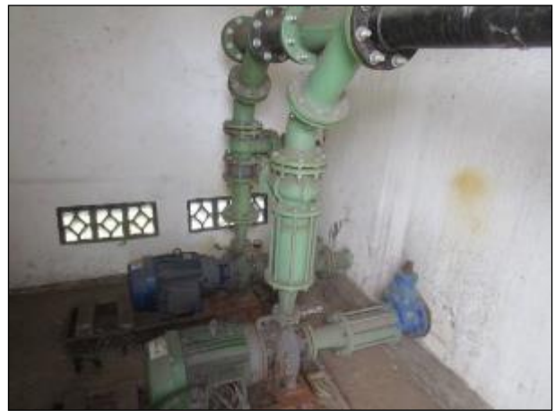
Figura 30: Bombas na ERAT Nova Brasília, junto à ETA.
