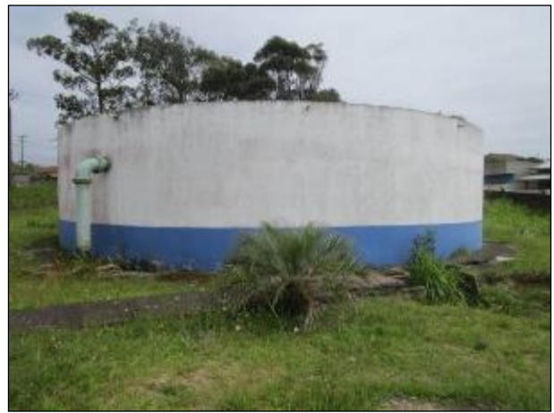
Figura 66: Vista do reservatório R1 com seu extravasor, manutenção do entorno precária e sem identificação da unidade.
