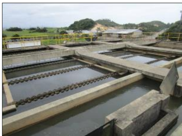
Figura 21: Parte da área de Tratamento da Água na ETA Nova Brasília.
