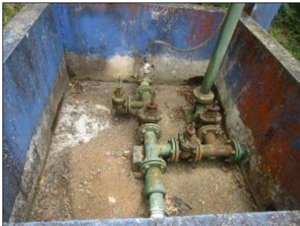
Figura 93: Equipamentos disponíveis no reservatório R8.
