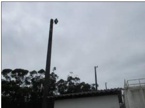
Figura 33: Vista do novo sistema de iluminação instalado na unidade ETA Nova Brasília, intuito de haver maior economia no consumo de energia e melhor luminescência.
