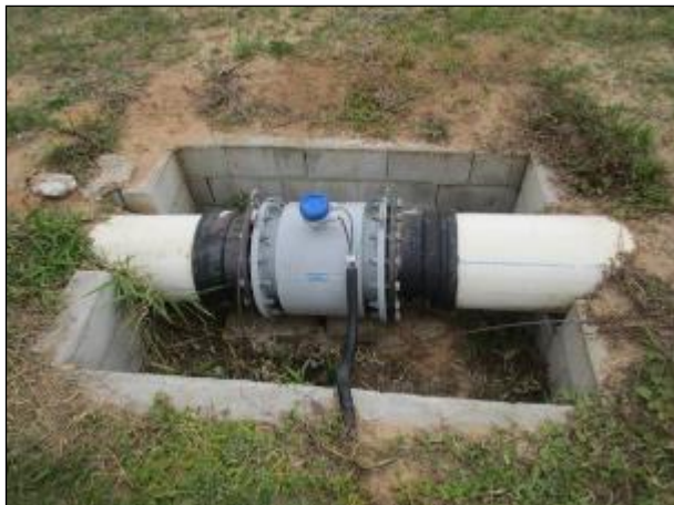
Figura 31: Adutora e macromedidor novo recentemente instalado.
