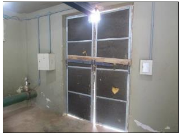
Figura 48: Porta instalada para fazer o isolamento acústico da unidade, boas condições.
