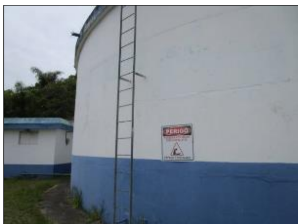
Figura 85: Vista da escada de acesso à parte superior da unidade, sem guarda-corpo. Ao fundo a edificação onde está a ERAT 08.
