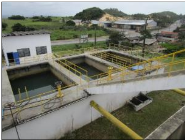
Figura 23: Parte da área de Tratamento da Água na ETA Nova Brasília.
