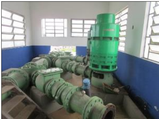
Figura 25: Local onde estão instalados os equipamentos de Recalque da Água Bruta.
