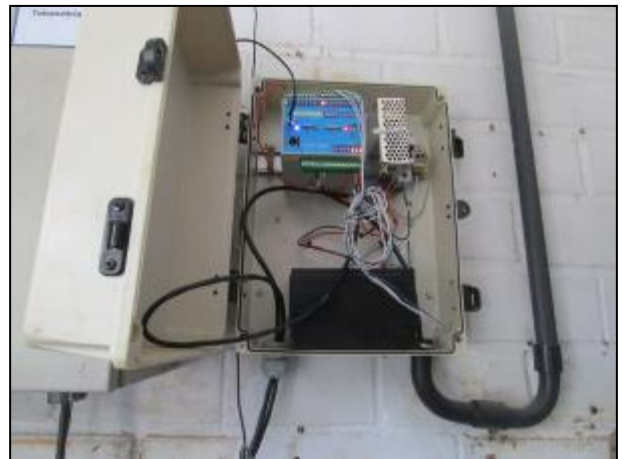
Figura 16: Equipamento para monitoramento remoto que envia os dados para a ETA Nova Brasília por internet telefônica (4G). Possui dois chips de diferentes operadoras.
