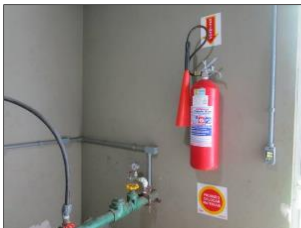
Figura 56: Vista de aparelho contendo agente extintor de incêndio BC disponível para uso imediato, localizado na ERAT 08.
