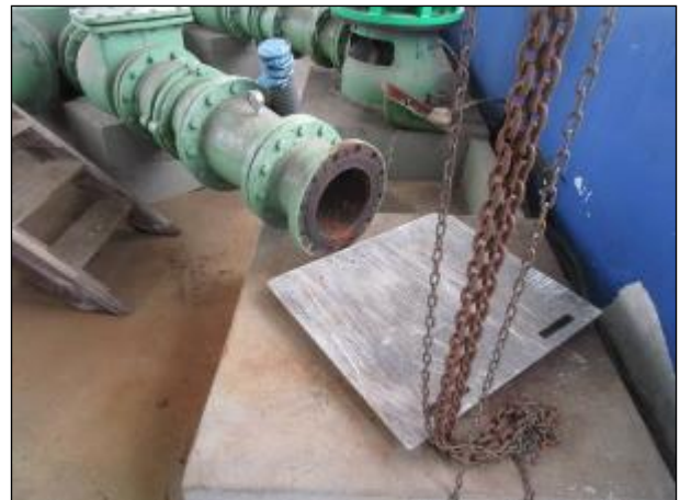
Figura 26: Uma das bombas da ERAT estava indisponível no momento da vistoria por estar passando por revisão eletromecânica.
