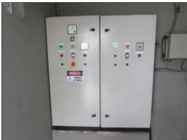
Figura 53: Painel de Controle da unidade ERAT 08, condições satisfatórias.
