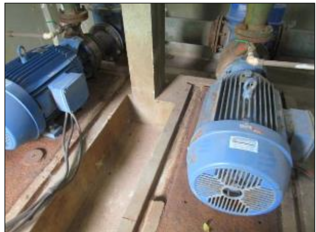
Figura 46: Detalhe das bombas disponíveis para recalque da água tratada na unidade ERAT 07.
